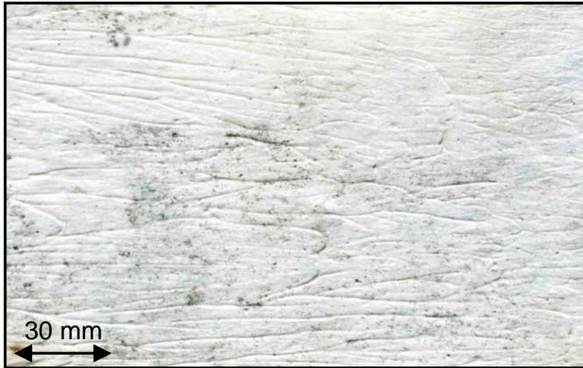
Bild 8.1: Porenbetonoberfläche, Bewuchsstellen mit Schwarzpilzen. Der mit Schimmelschutz gestrichene Porenbeton wurde 18 Monate bei hoher Feuchtigkeit bebrütet.
