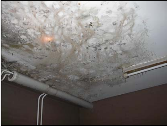
Bild 3.1: Wasserschaden auf GK-Decke mit massivem Befall durch Penicillium chrysogenum
